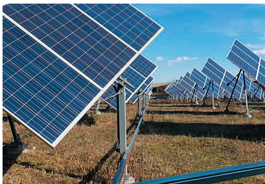
Fig. 1.13. Parcul fotovoltaic din mun. Ungheni
